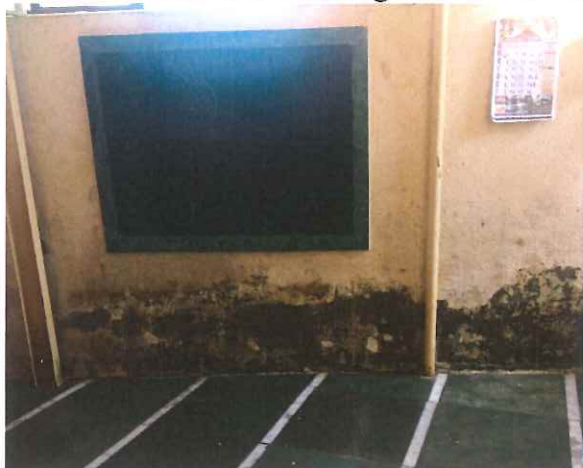
Sept. 2017: Marode Wände im Kindergarten-Raum.
